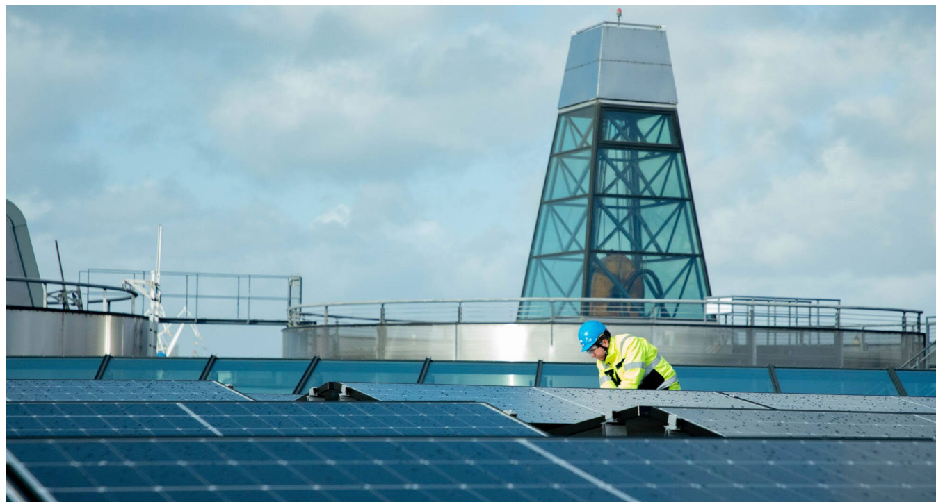
Museet i Stavanger tilegnet den norske oljehistorien er delvis soldrevet. Caverion har montert et solcelleanlegg som dekker rundt 20 prosent av energiforbruket på museet.
