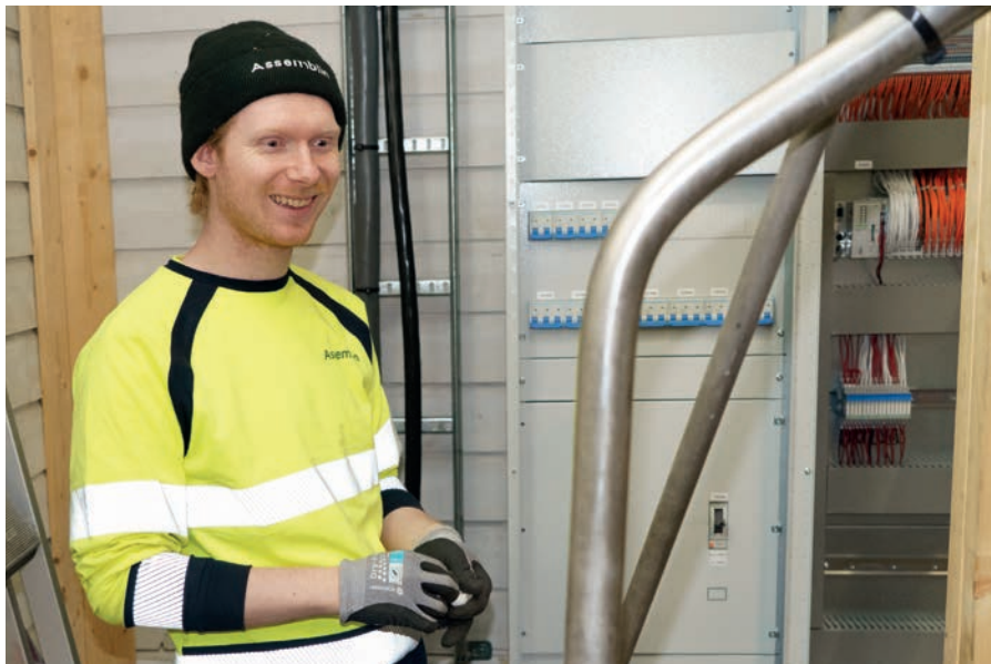
Elektriker Jørgen Wærn Jørlo har jobbet med installeringen av vakuumtørkeren på Svalbard Bryggeri.
